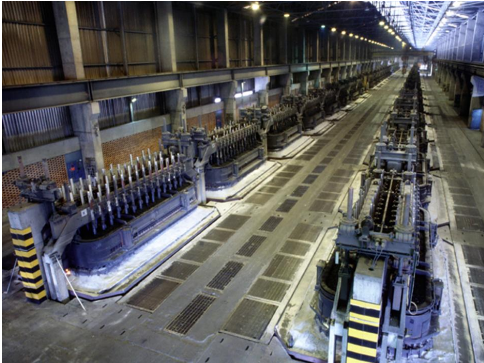
Fig. 2.22 – Sala de cubas de pinos verticais - VSS
