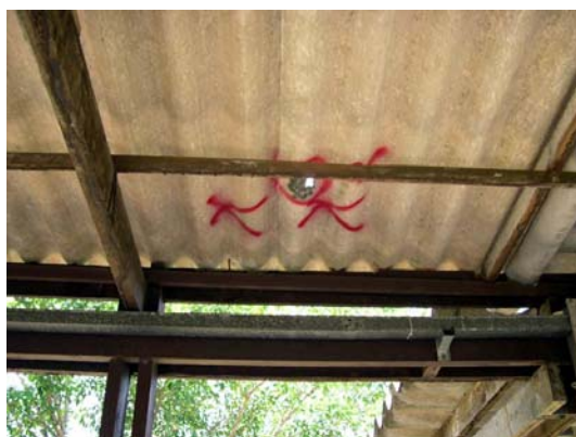
Foto 60 - Passarela Bloco da Química-QB, na UFPA. Observar orifício em telha amostrada.
