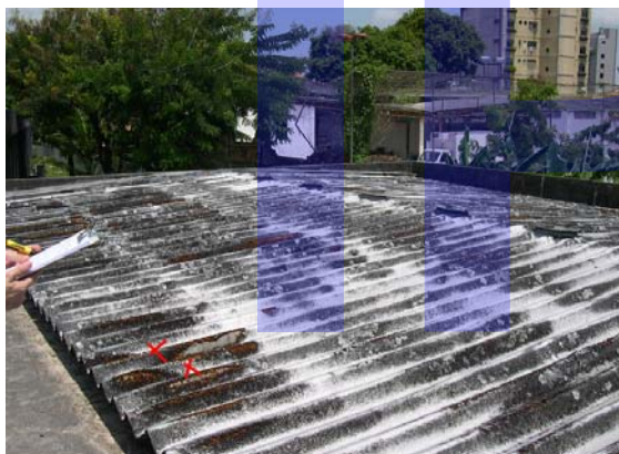
Foto 70 – Telhado do depósito do Banco do Brasil. A telha possui uma cobertura de espuma rígida com camada de tinta prateada.
