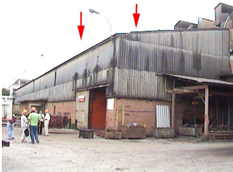
Foto 15 – Pavilhão da Fábrica de Eixos, destacando-se os locais aproximados de coleta das amostras de telhas.
