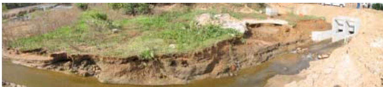
Fig. E.8 - Vista de canal de descarte de efluentes com intensos processos erosivos, em Aracati.
