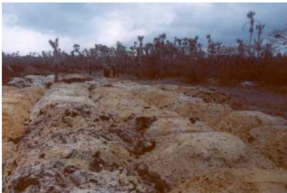
Figura 3.B.20 - Remoção da camada fértil do solo de várzea após o desmatamento do carnaubal, para a implantação dos viveiros de camarão ao longo do estuário do rio Aracatimirim. Pequenos canais de maré e afluentes foram completamente extintos. Intervenções clandestinas e diretamente vinculadas à Terra Indígena Tremembé de Almofala (coordenadas UTM E=405015.435 e N=9667077).
