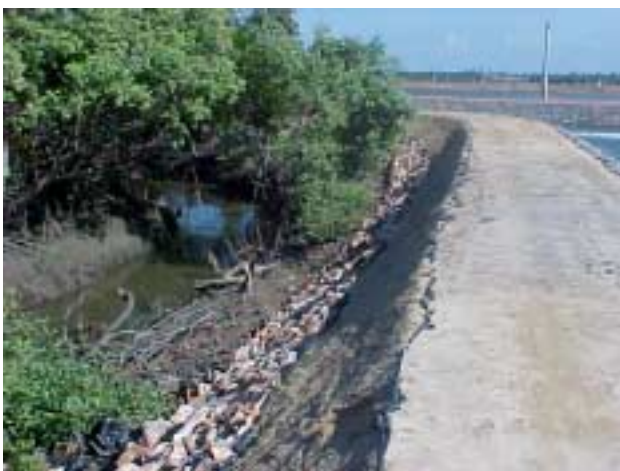
Fig D.2 – Canal adjacente a vegetação de mangue, com canal escavado no interior do manguezal.
