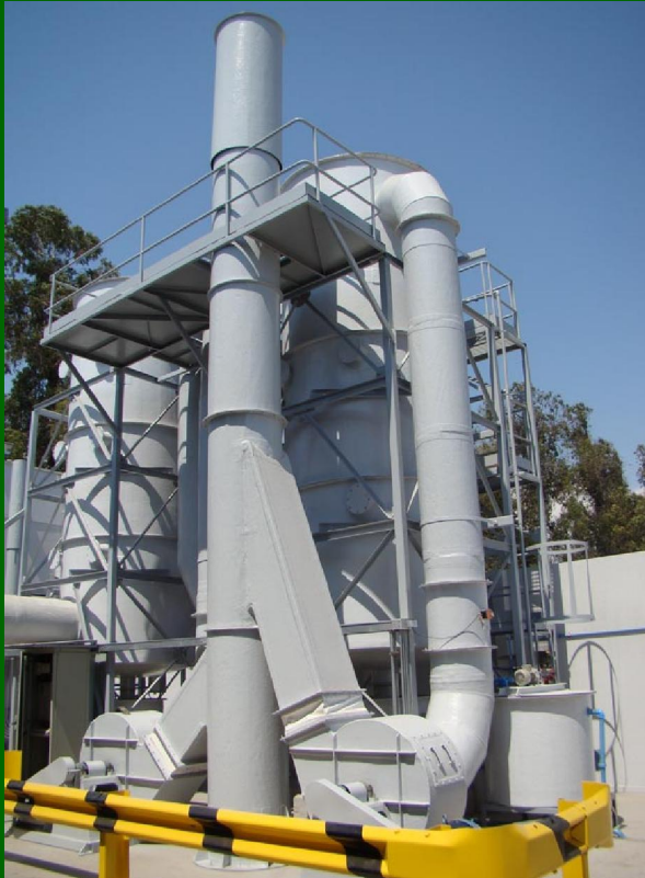
Fig. 1 - Lavador de gases
