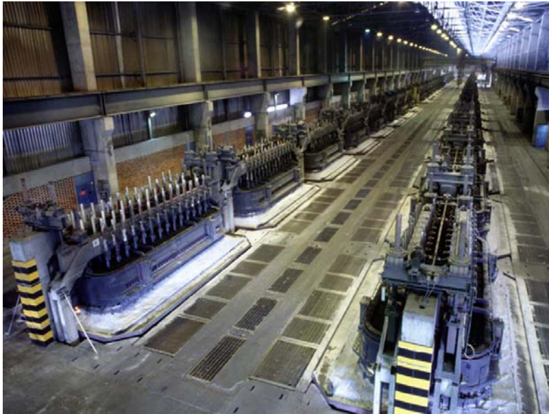
Sala de cubas de pinos verticais - VSS
