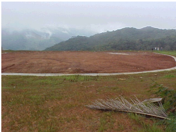
Figura 3- Parte superior do aterro, com recobrimento de argila e manta geotextil para impedir a infiltração de água
