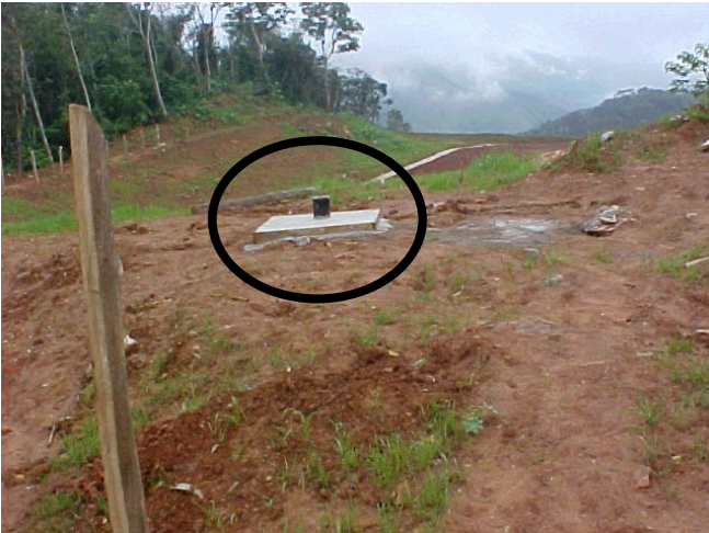
Figura 4 - Aterro do Rocha: tubulação de ponto de inspeção para coleta de água para análise.
